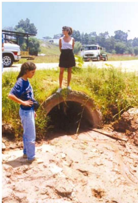
Figura 1.2.2.a – Foto de pontilhão obstruindo a drenagem.
